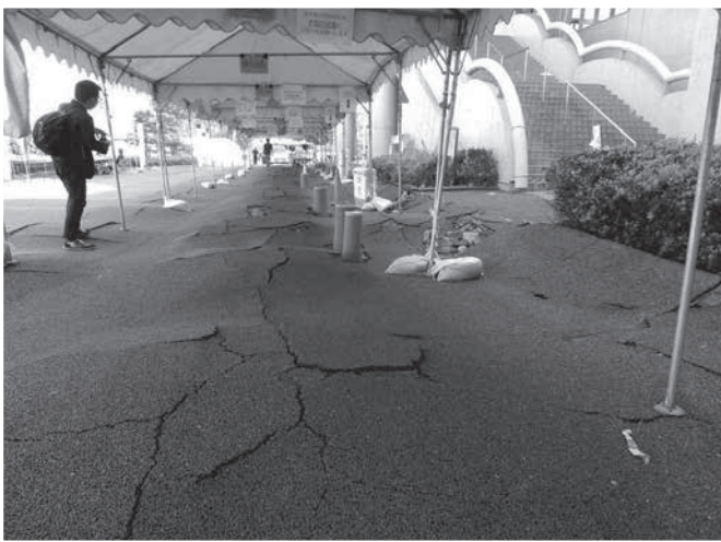
益城町ではアスファルトが波打っていた
