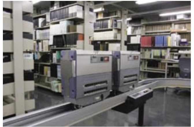
図書自動搬送機 (テレリフト)
