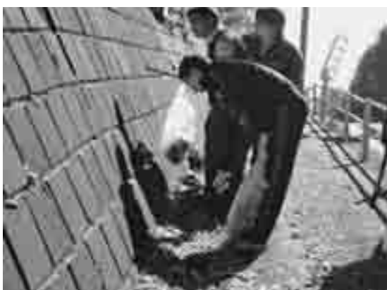
配水管の中に空き缶を発見
