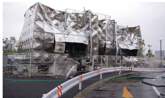
東日本大震災で被害を受けた貯水タンク(宮城県名取市)。地震によって中に収められている水が揺れ、タンク内外壁を破壊してしまった。
