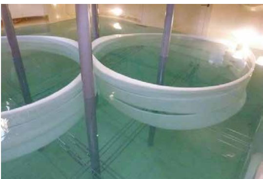
先生の研究成果である「8字型浮体式波動抑制装置（通称：『タンクセーバー・波平さん』 ® ）」。貯水タンク内部に設置するだけでスロッシング現象を抑え、震災時のタンク破壊・破損を防げる。
