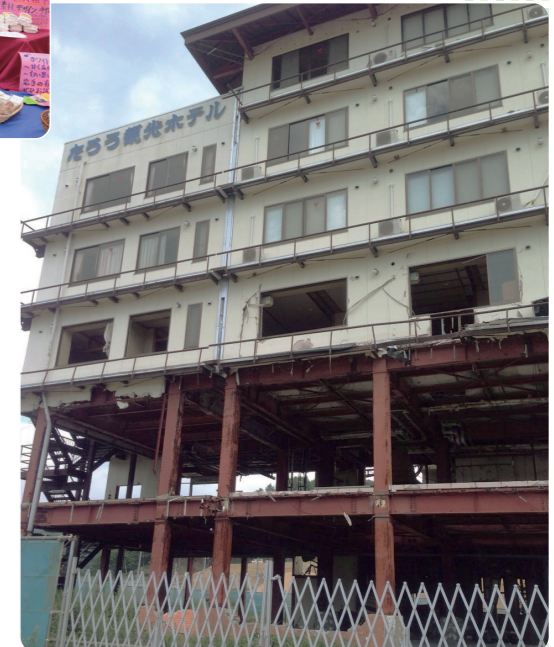
骨組みがむき出しになった「たろう観光ホテル」
