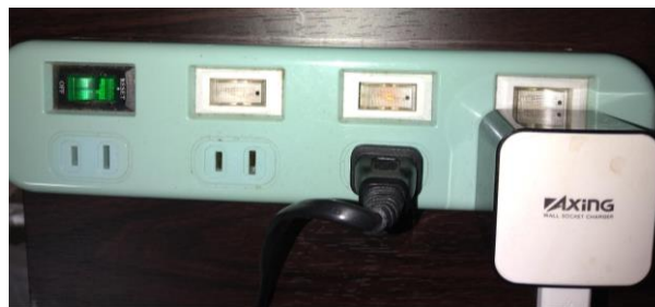
写真2. テーブルタップ
